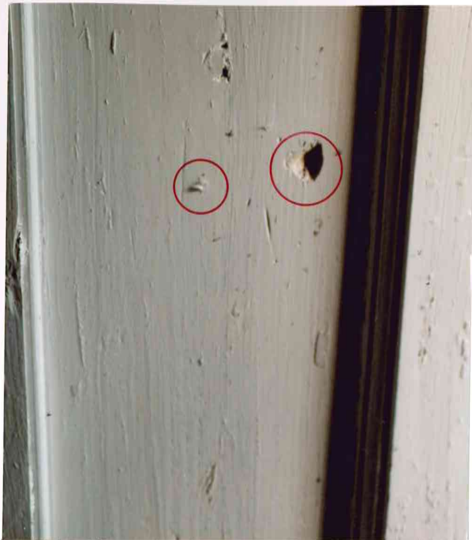
Foto dalla n. 65 alla n. 68: ...particolari delle impronte da impatto registrate dalla superficie dello sportello oscurante a contatto del vetro. In evidenza frammenti di vetro infissi in prossimità dell'area interessata.
