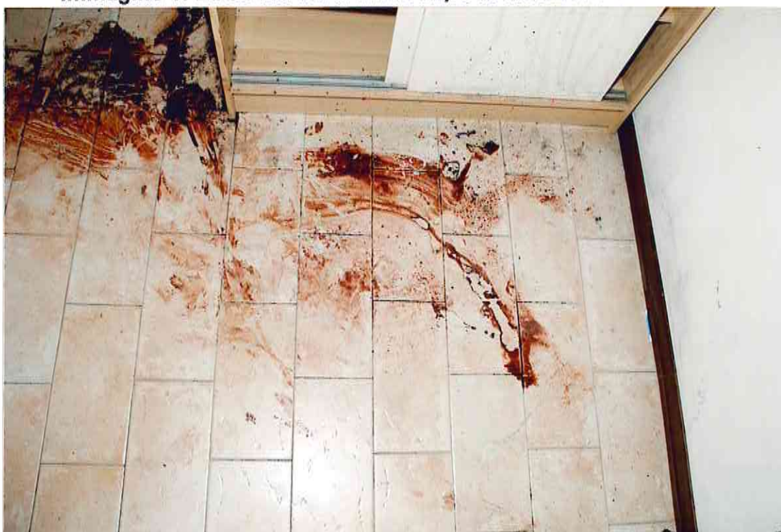
Immagine 2: Le tracce sul pavimento nei pressi dell'armadio
